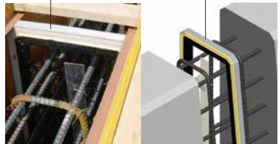
Sタイプ設置
